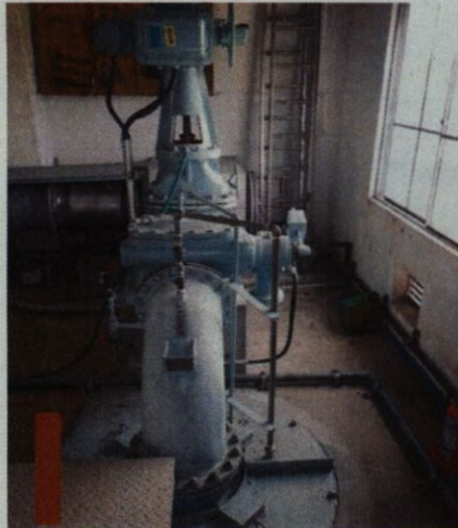
ポンプ配管(水中ポンプ上部)
