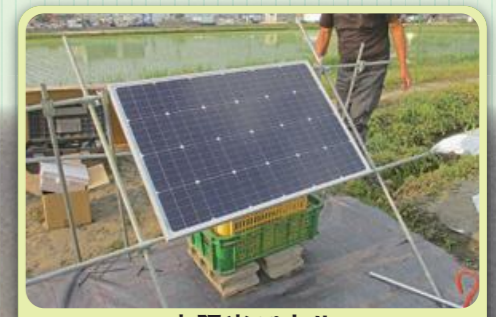
太陽光パネル
