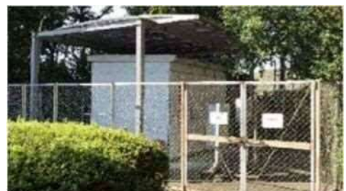
高圧受電所設備
