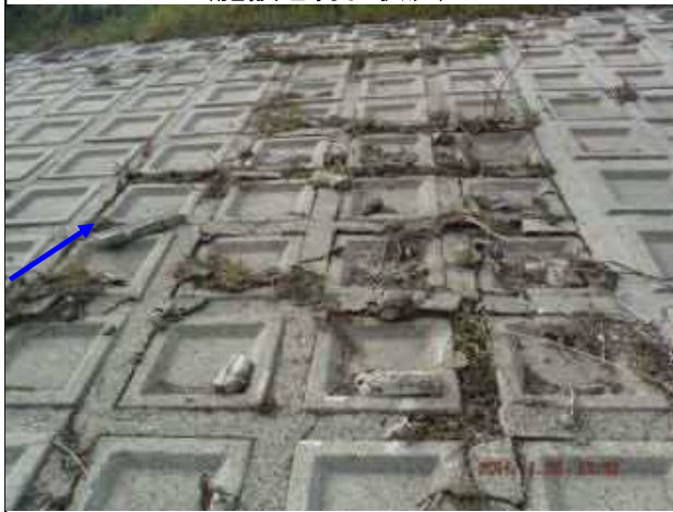
(施設老朽化状況)
