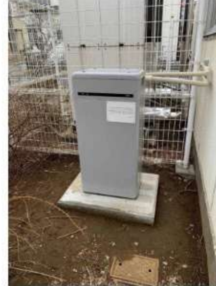
緑が丘公民館（蓄電池）
