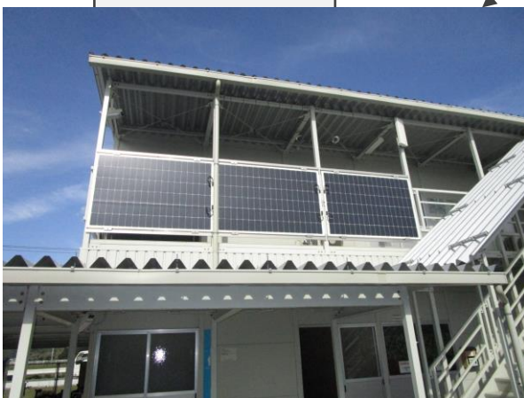
岡山営業所のPV：4.8kW (超軽量太陽光パネル)
