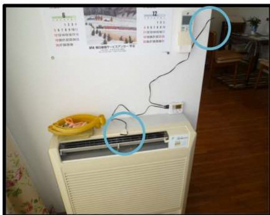
エアコンの吹き出し口
