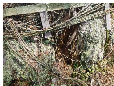
空洞化が進んでいる。 (打音検査による確認)
