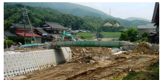
中島橋 河嶋建設 橋桁がかかりました 現在通行止です。ご迷惑をおかけしております
