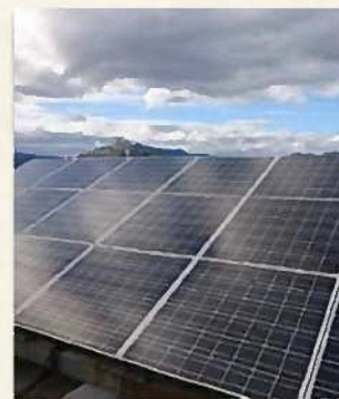
屋上ソーラーパネル
