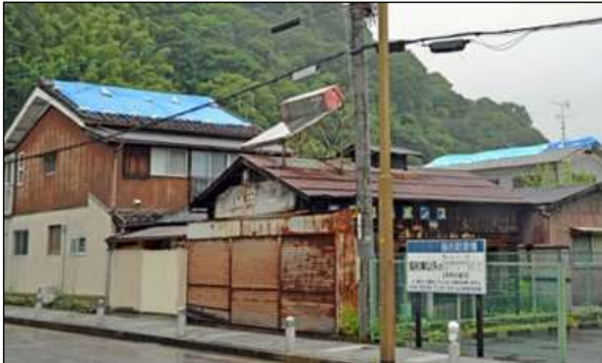
↑ 雨に備え損傷した屋根にブルーシートを被せた住宅（八幡市）
