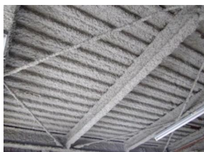
アスベスト含有建材の例
