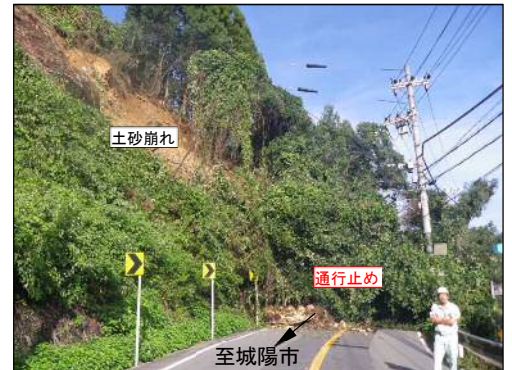
【被災の様子 平成 25 年 9 月】
