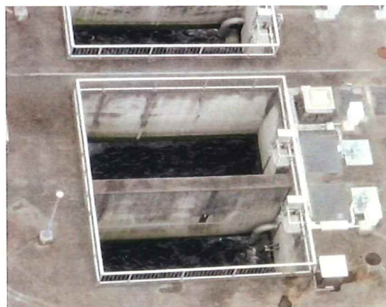
[写真3 ろ過池 全景]
