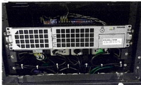
放流判断支援サーバ 【更新前】
