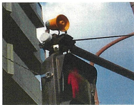
④音響式交通信号付加装置
