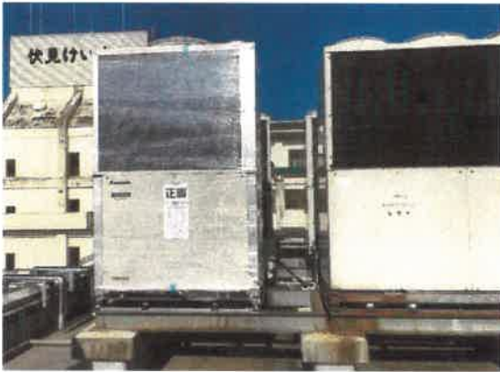
室外機（完成後）
