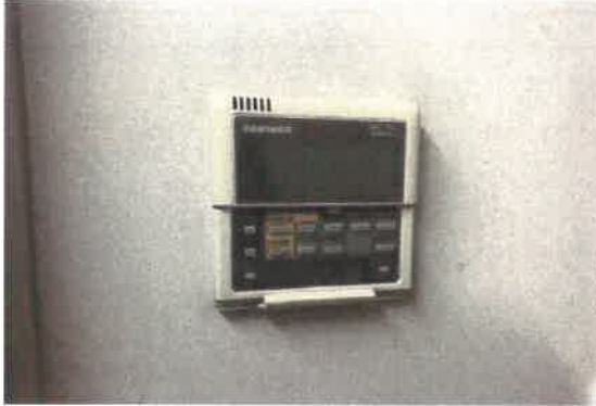
リモコン（着工前）
