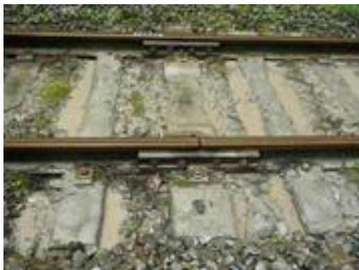
レール継ぎ目の噴泥現象
