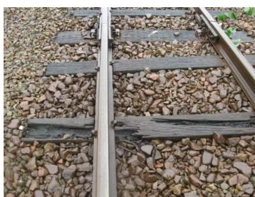
腐朽マクラギの例
