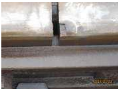
50Tレールの端部欠損
