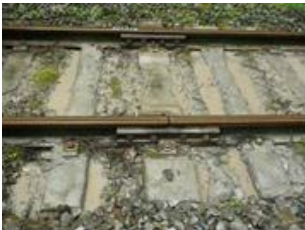
レール継ぎ目の噴泥現象
