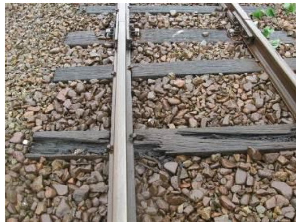
腐朽マクラギの例
