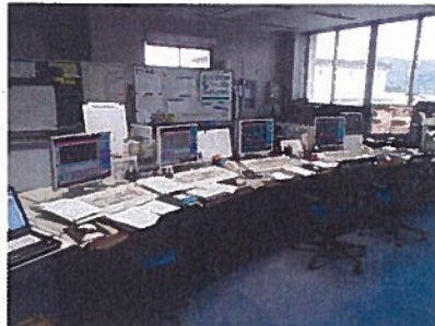
中央監視制御装置（宇治既設）
