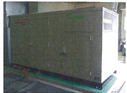
(例) 久御山広域ポンプ場自家発電
