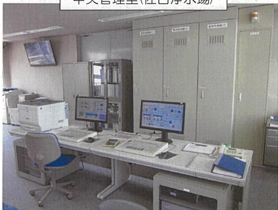
中央管理室(佐古浄水場)
