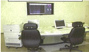
中央監視室(薪浄水場)
