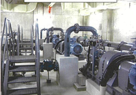
ポンプ室(宮ノ口受水場)
