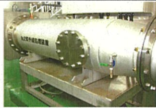
紫外線処理室(薪浄水場)
