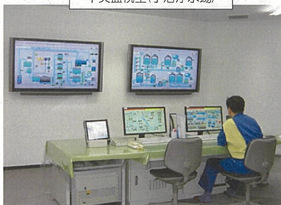
中央監視室(宇治浄水場)
