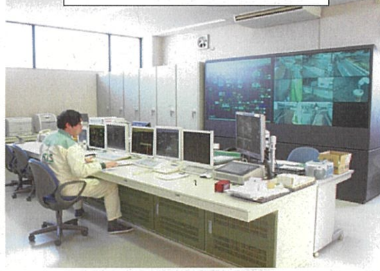
浄水場監視室(美濃山浄水場)
