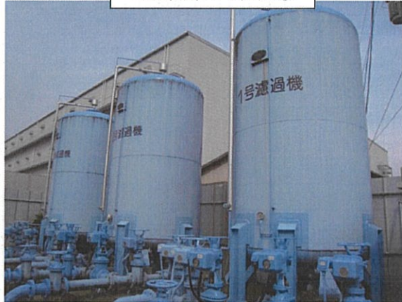
ろ過機(佐古浄水場)
