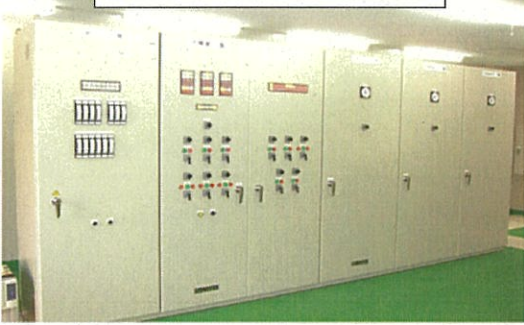
電気室(宮ノ口受水場)
