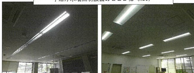
宇治浄水場照明設備のLED化(H30)
