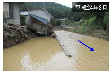
志津川の河岸欠壊(宇治市志津川)
