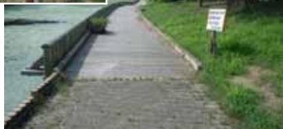
注意看板の設置(雑水川・南郷池)
