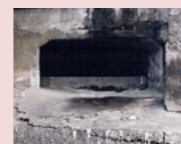
下水道雨水吐
