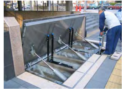
京都駅前地下街入り口の止水板
