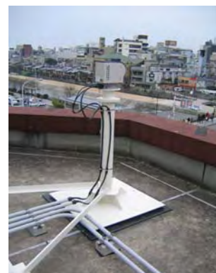
鴨川沿川の防災カメラ
