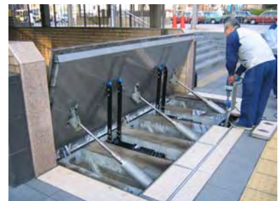
京都駅前地下街入り口の止水板
