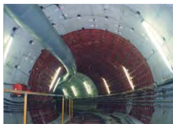
吐口から流れ出す水の量を減らすため、 下水を貯める貯留管の建設 (京都市上下水道局HPより)
