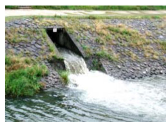
合流式下水道からの雨天時放流水 (京都市上下水道局HPより)
