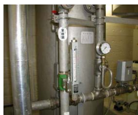
公共施設での雨水利用施設その1 (京都府庁西別館の地下)
