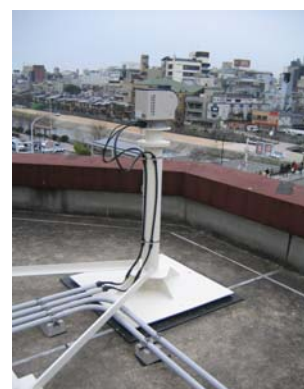
鴨川沿川の防災カメラ
