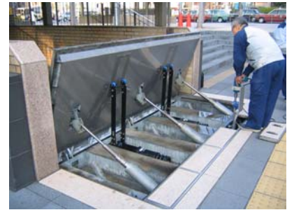
京都駅前地下街入り口の止水板
