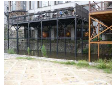
護岸が低く浸水の恐れがある箇所
