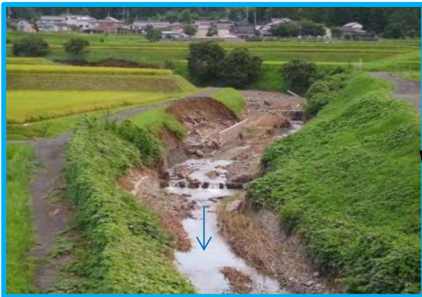
河岸侵食(室川 むろ )
