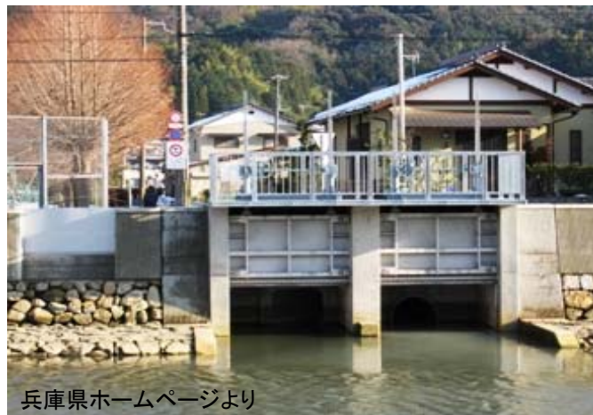
排水樋門・排水ポンプ
