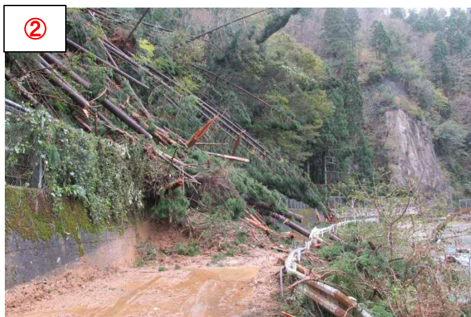
② なんたんしみやまちょうらいし きょうとひろがわらみやま 【場所】南丹市美山町白石 (主) 京都広河原美山線 【被災状況】法面崩壊 延長120m 【復旧内容】吹付法柵 120,000千円
