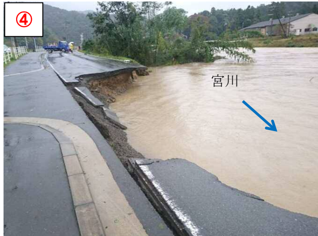
④ ふくちやましおおえちようせき おやべおおえみやづ 【場所】福知山市大江町関 (主) 綾部大江宮津線 【被災状況】河岸浸食 延長40m 【復旧内容】大型ブロック工 40,000千円
