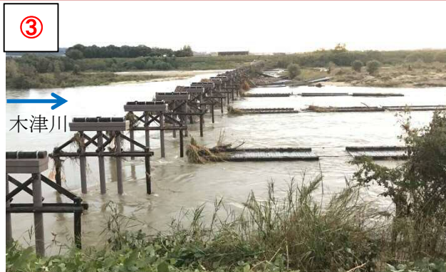
③ やわたしこうつや くみやまちょうさやま やわたじょうよう 【場所】八幡市上津屋～久御山町佐山 (一) 八幡城陽線 【被災状況】橋梁上部工流出 延長357m 【復旧内容】上部工再据付 45,000千円
