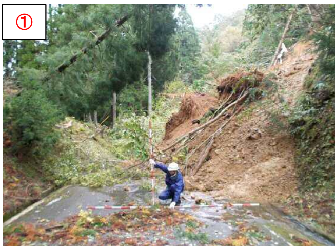
① あやべしむつよりちようおおいわ まいづるわち 【場所】綾部市睦寄町大岩 (主) 舞鶴和知線 【被災状況】法面崩壊 延長60m 【復旧内容】法面工 150,000千円
