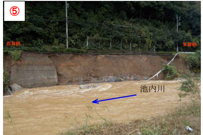
⑤ まいづるしべっしょ いけうちきょうだ 【場所】舞鶴市別所 (主) 池辺京田線 【被災状況】路肩決壊、河岸浸食 延長50m 【復旧内容】大型ブロック積工 80,000千円
