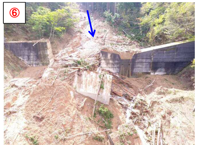
⑥ あやべしこやおかまち あさねがわ 【場所】綾部市古屋岡町 普通河川 朝根川 【被災状況】砂防堰堤損傷等 延長250m 【復旧内容】砂防堰堤復旧工 100,000千円
