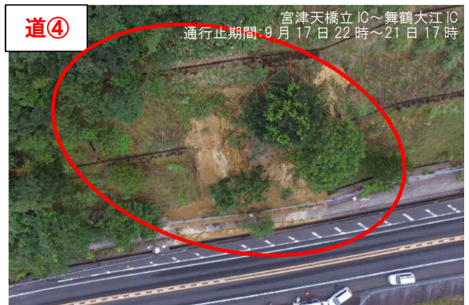
道④ 【場 所】 みやづし きょうとじゅうかんじどうしやどう 宮津市 京都縦貫自動車道 (国道 478 号) 【被災状況】法面崩壊 延長 35m (2 箇所 2 工区) 【復旧内容】吹付法柁 100,000 千円
