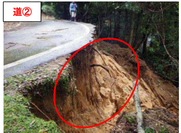
道② 【場 所】 よさのちよう なかふじかやせん 与謝野町 (一) 中藤加悦線 【被災状況】路肩欠壊 延長 20m (1 箇所 4 工区) 【復旧内容】大型ブロック 20,000 千円
