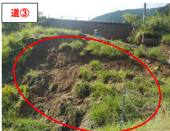
道③ 【場 所】 ふくちやまし しものじようかみかわぐちいしやじようせん 福知山市 (一) 下野条上川口停車場線 【被災状況】法面崩壊 延長 73m (3 箇所) 【復旧内容】吹付法柁 45,000 千円
