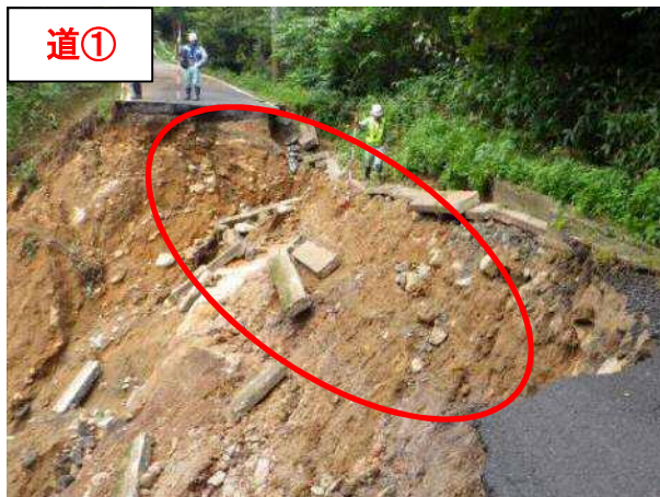
道① 【場 所】 きょうたんごし いねちよう 京丹後市・伊根町 (一) きゆうそいねせん 久僧伊根線 【被災状況】車道欠壊 延長 234m (7 箇所 7 工区) 【復旧内容】擁壁工・盛土 204,000 千円
