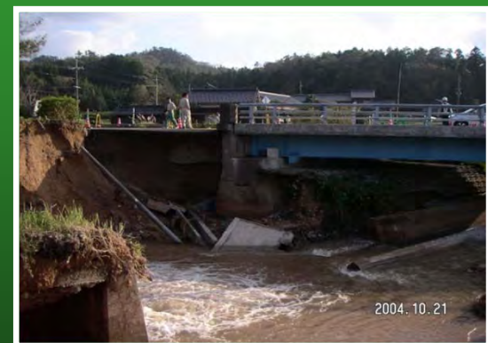
H16.10 台風23号被災状況
