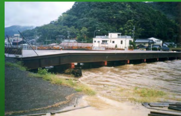
H10.9 台風7号被災状況
