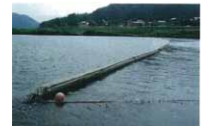
塩水の遡上を防ぐために由良川に設置した防塩幕
