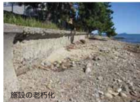
図 1-3-7 堤防の老朽化
