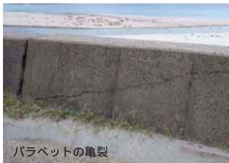
図 1-3-6 護岸の老朽化
