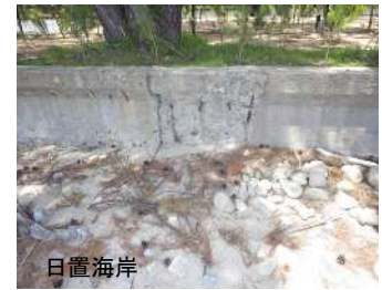
図 1-5-7 老朽化した海岸保全施設
