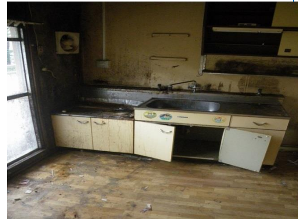
<床や換気扇等が破損している>
