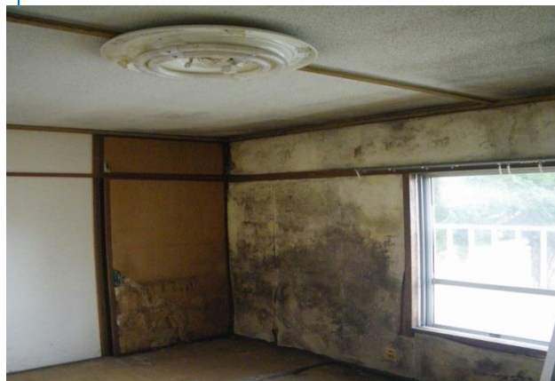
<壁面にカビが発生している>
