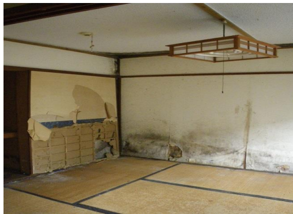
<壁面や襖が剥がれている>
