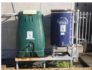
府庁2号館屋上に設置されている「マイクロ呑龍」
