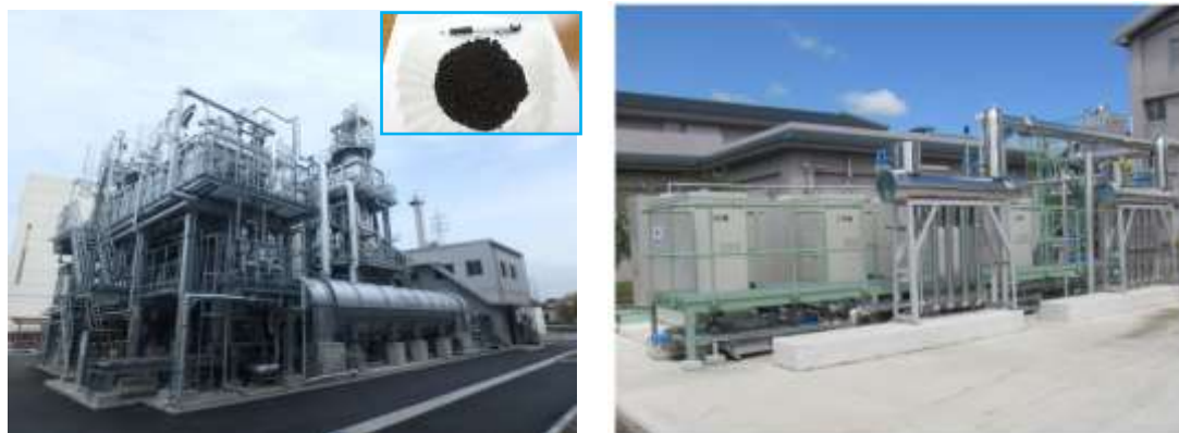
図 2.15 固形燃料化施設（左：洛西）と消化ガス発電設備（右：木津川上流）
