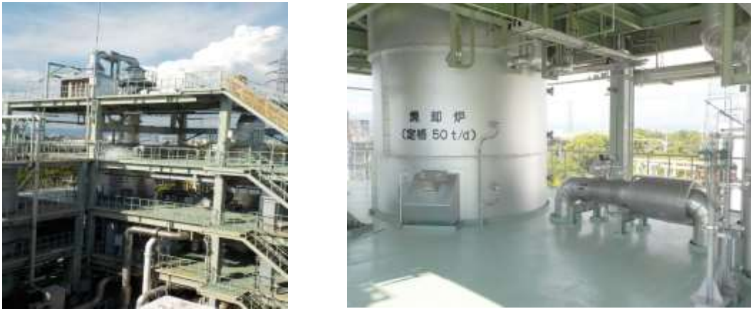
図 5.4 3号焼却炉（左：全景、右：焼却炉本体）
