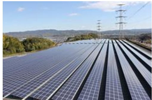
けいはんな学研都市に整備された太陽光発電設備（出典：関西電力株式会社）
