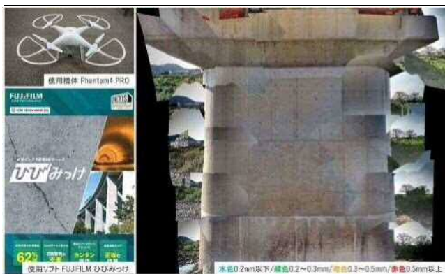
コンクリート構造物の画像の合成と損傷の自動検出
