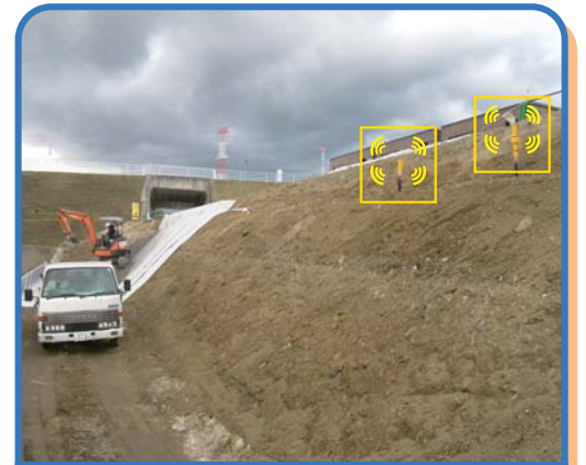
法面 法面の崩壊を監視し、異常時に警報音で知らせます
