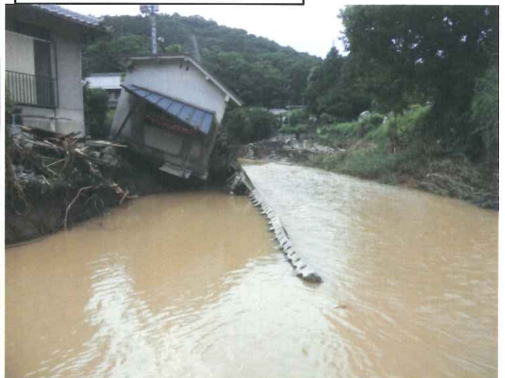
14日未明 決壊箇所 民家
