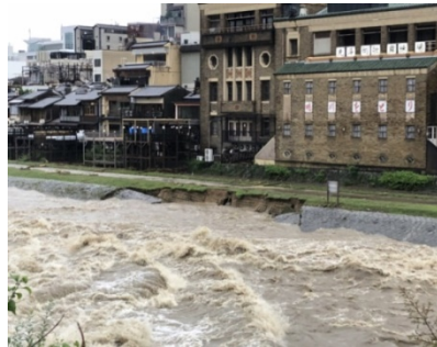
かもがわ ■鴨川(三条大橋南側)における 護岸の一部損壊
