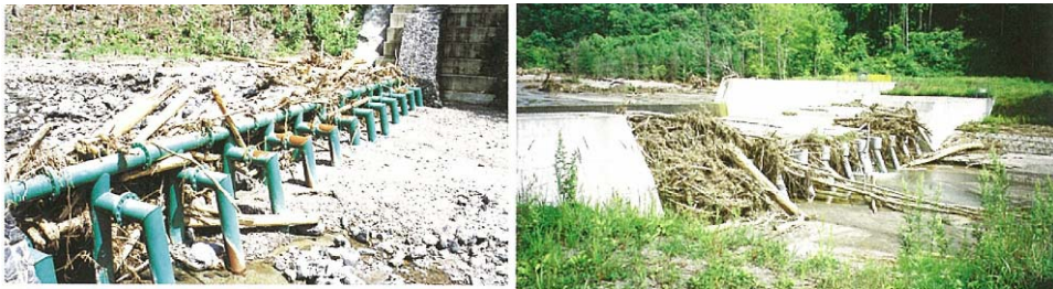
図 5-3 掃流区間に設置された流木捕捉工
