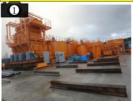
土砂と汚泥を分離する設備状況
