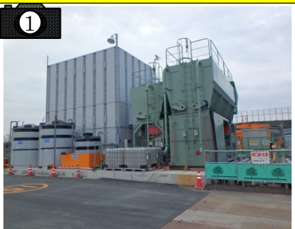
土砂と汚泥を分離する設備状況
