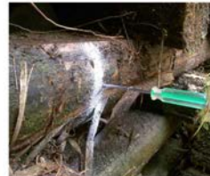
軽度の腐朽状況 (本体部)
