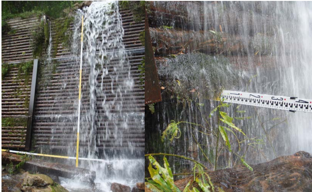
図-5 落差が大きく、基礎部が洗掘により露出・損壊した構造物の事例
