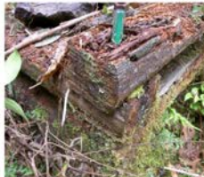
褐色腐朽菌による劣化 (右岸袖部)
