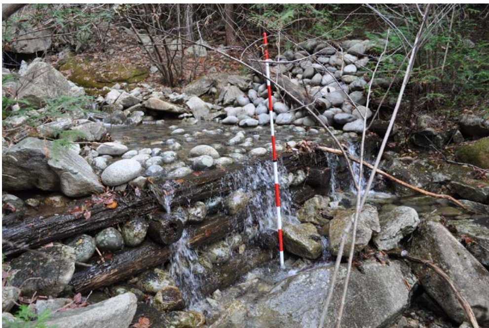
図-6 部材の劣化に伴い袖部が損壊した木製治山ダム (カラマツ材を使用：施工後 24 年経過)
