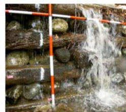
中詰材流出の兆候 (本体部)
