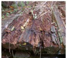
褐色腐朽菌による劣化 (右岸袖天端)
