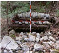
連結部が外れている (右岸袖天端)
