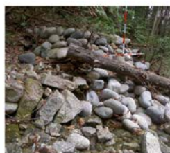
中詰材の流出 (左岸袖部)
