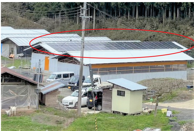
太陽光発電パネルを設置した鶏舎(写真中央)
